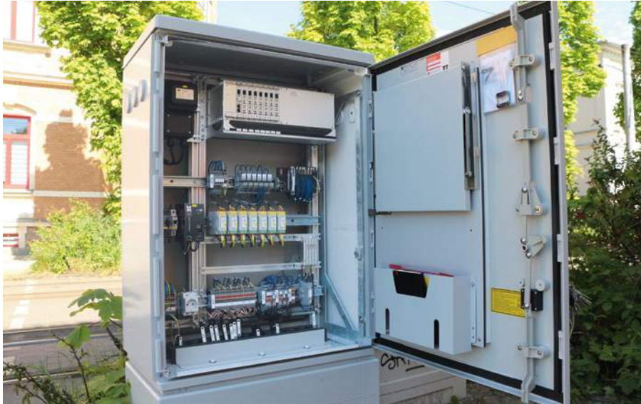
3: Steuerschrank der neuen Leittechnik nahe der Haltestelle Saarstraße (02.06.2021)
